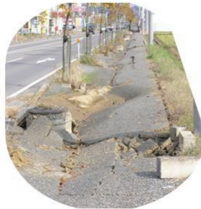
地表が陥没した管路
