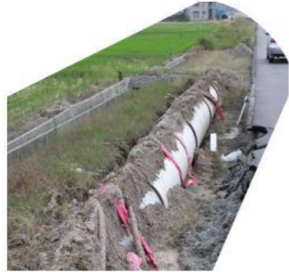
浮上した管路
