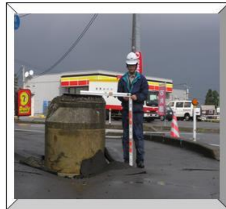
1m浮上したマンホール
