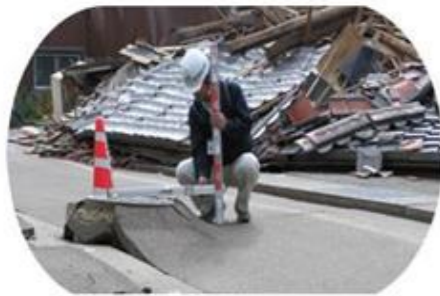
倒壊家屋とマンホール
