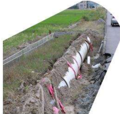
浮上した管路
